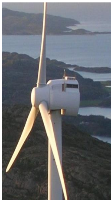
ScanWind Demo I Nord Trönderlag Diameter 80 m, 2.5 MW
