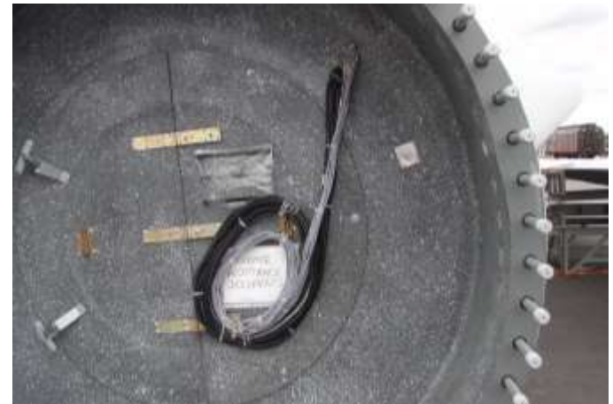
På bilden visas kraftmatnings-kablarna till avisningssystemet för anslutning in mot navet
